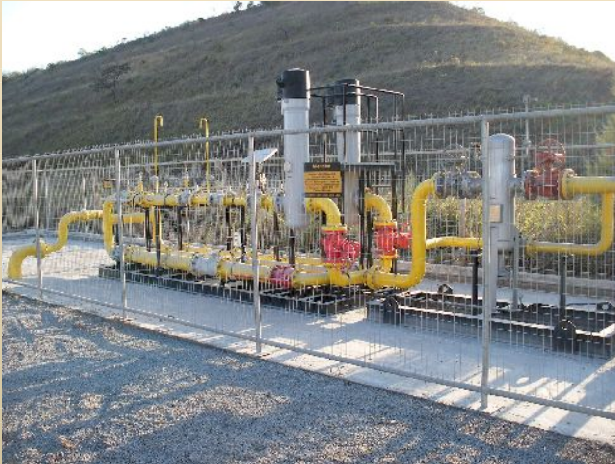
Estação de controle da concessionária.
